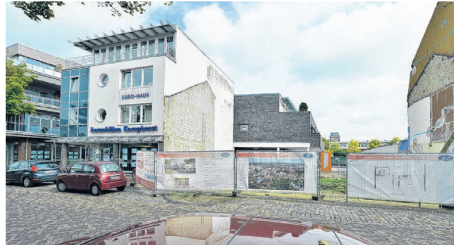
Das Bavaria-Kino ist abgerissen. Zwischen Immobilien Kamphorst und Büro Avers wird das neue Wohn- und Geschäftshaus gebaut. Foto: Jürgen Lükens
